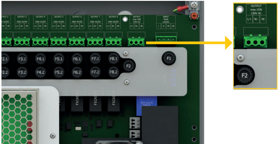
Abb. 20: Anschluss externe AC-Verbraucher
